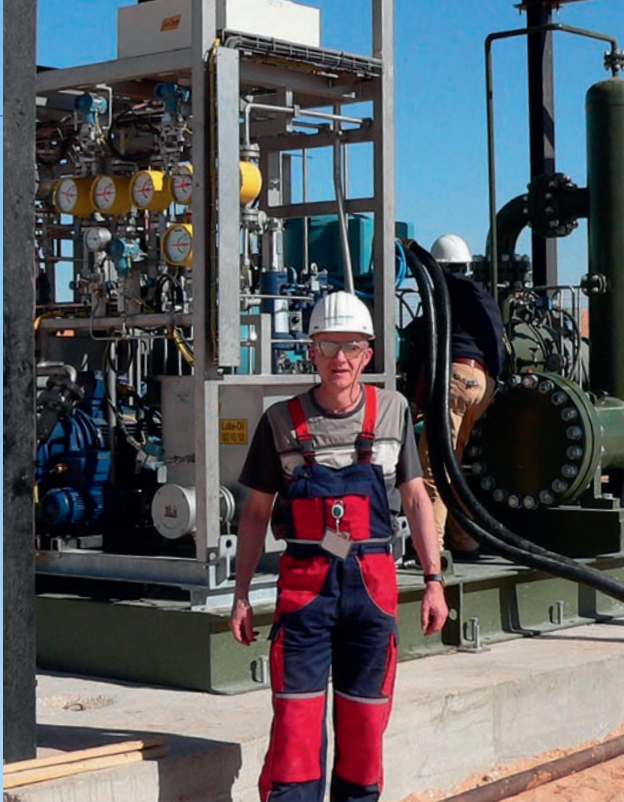
Ulf Mester war vor Ort als Projektmanager verantwortlich für die Inbetriebnahme der Leistriz Pumpen.
